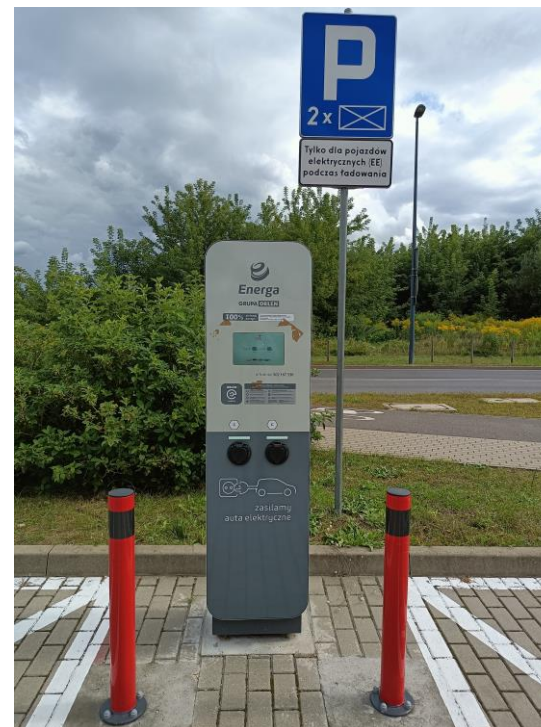
Rys. 2.6 Stacja ładowania pojazdów elektrycznych w Olsztynie
