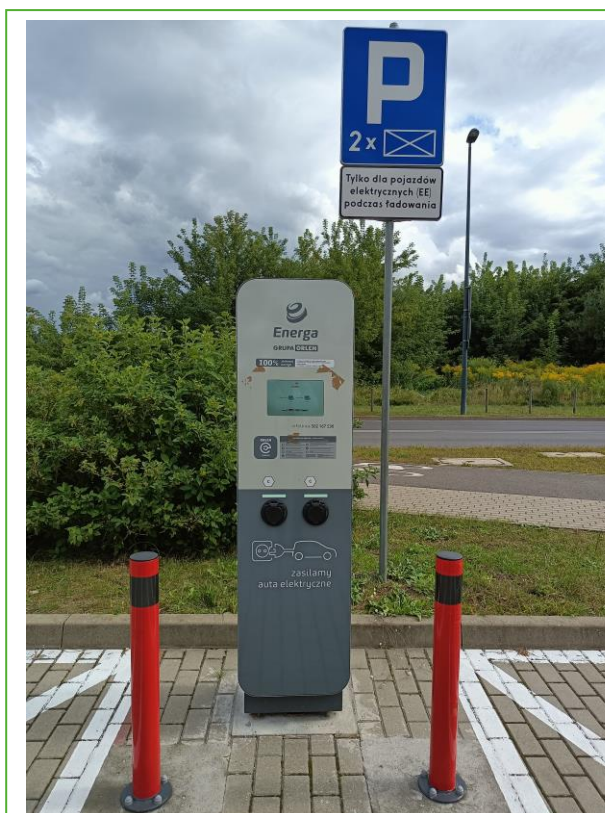
Rys. 6.17 Stacja ładowania pojazdów elektrycznych w Olsztynie.
